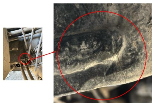
Зураг 14. Доод рамны зүүн гуянд шинээр үүссэн цууралт
